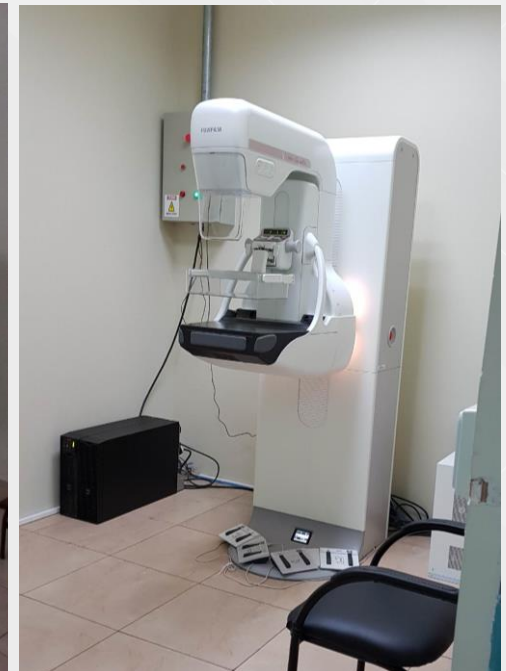
Creación, adecuación (instalación de láminas de plomo) y apertura del área de mamografías
