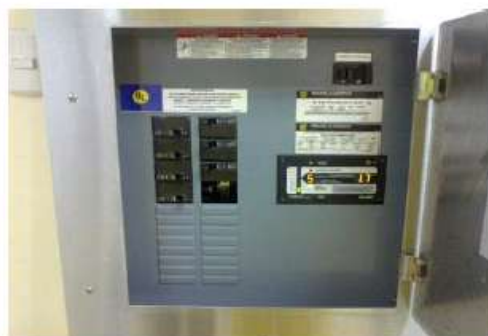
SUBTABLERO DE DISTRIBUCIÓN INSTALADO EN EL SECTOR DE QUIRÓFANOS
