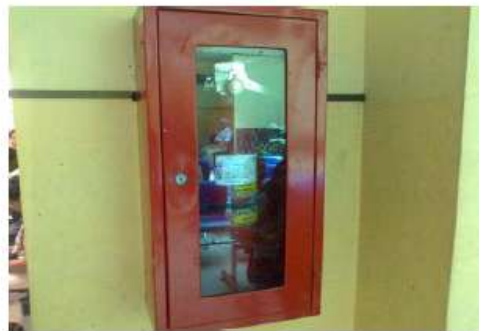
TIPO DE EXTINTORES INSTALADOS
