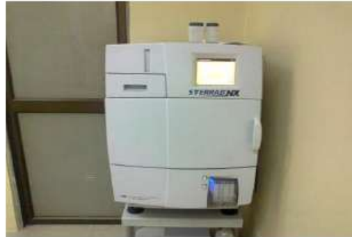
EQUIPO INSTALADO EN EL SECTOR DE QUIRÓFANOS
