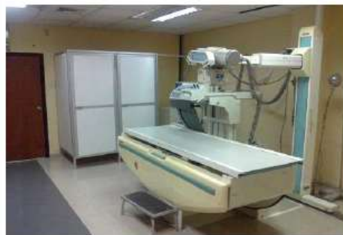
EQUIPO DE RX INSTALADO EN EL CENTRO DE ATENCIÓN
