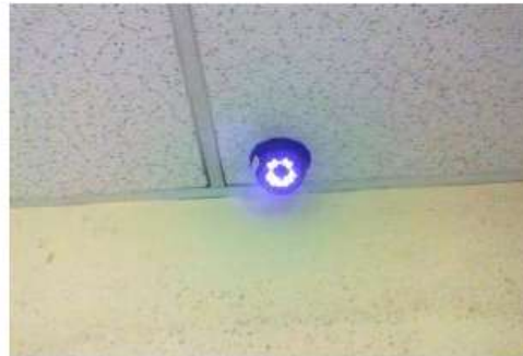
TIPO DE CÁMARAS DE VIDEO PARTE DEL CCTV
