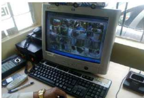
SECTOR DE MONITOREO DEL CCTV
