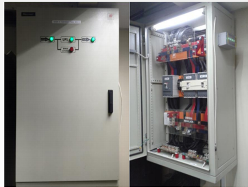
Fig. 14 Vista interior del tablero de Bypass del UPS # 2
