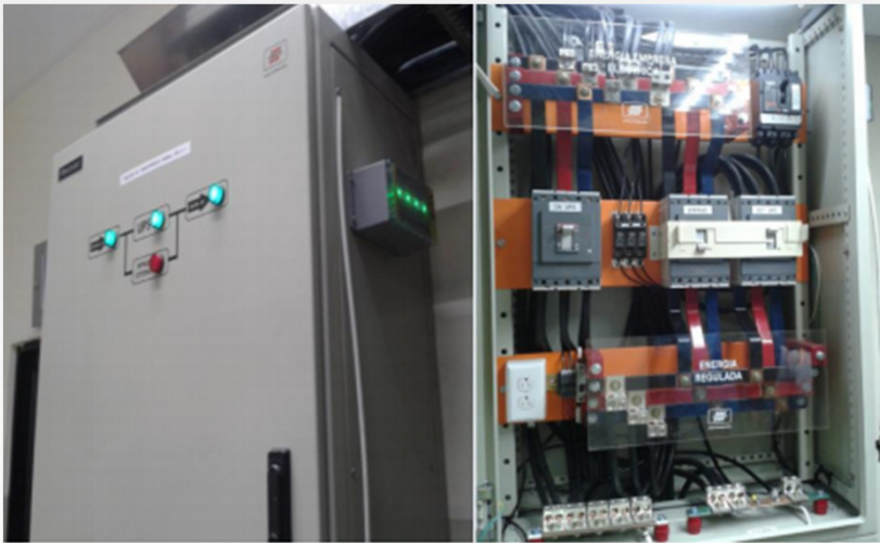
Fig. 13 Vista interior del tablero de Bypass del UPS # 1
