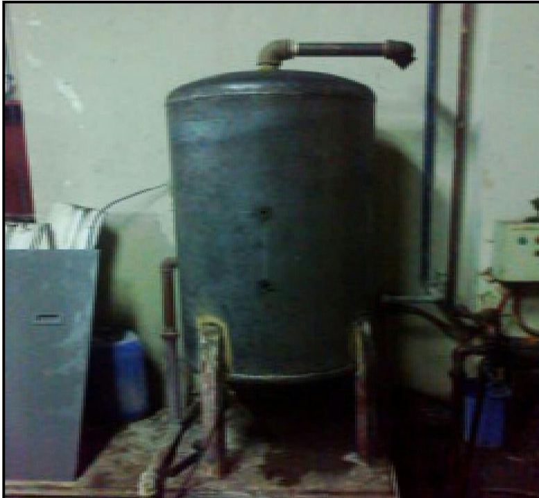
Estado en que se encontraba el sistema de vapor generado por los Calderos del Hospital General de Machala
