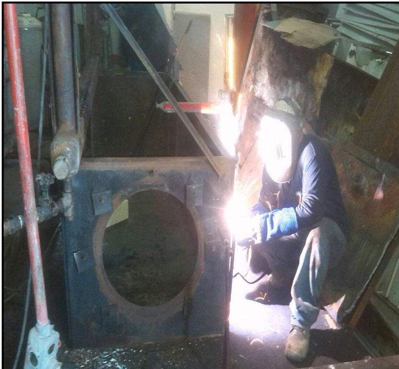
Intervención en el sistema de vapor generado por los Calderos del Hospital General de Machala
