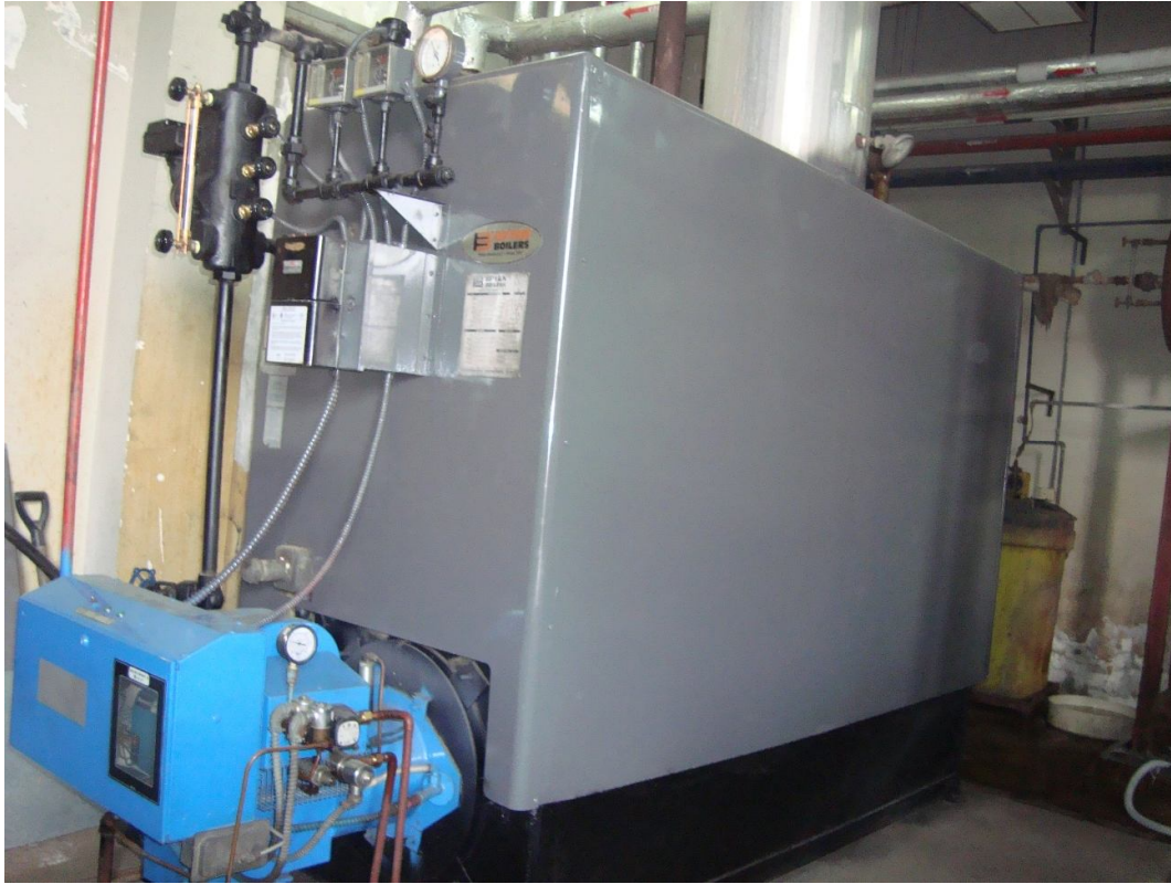
Calderas para generación de Vapor para el Hospital General de Machala
