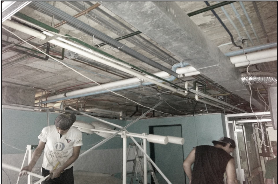
Reconstrucción del tumbado del área de Quirófano del Segundo Piso del Hospital General de Machala
