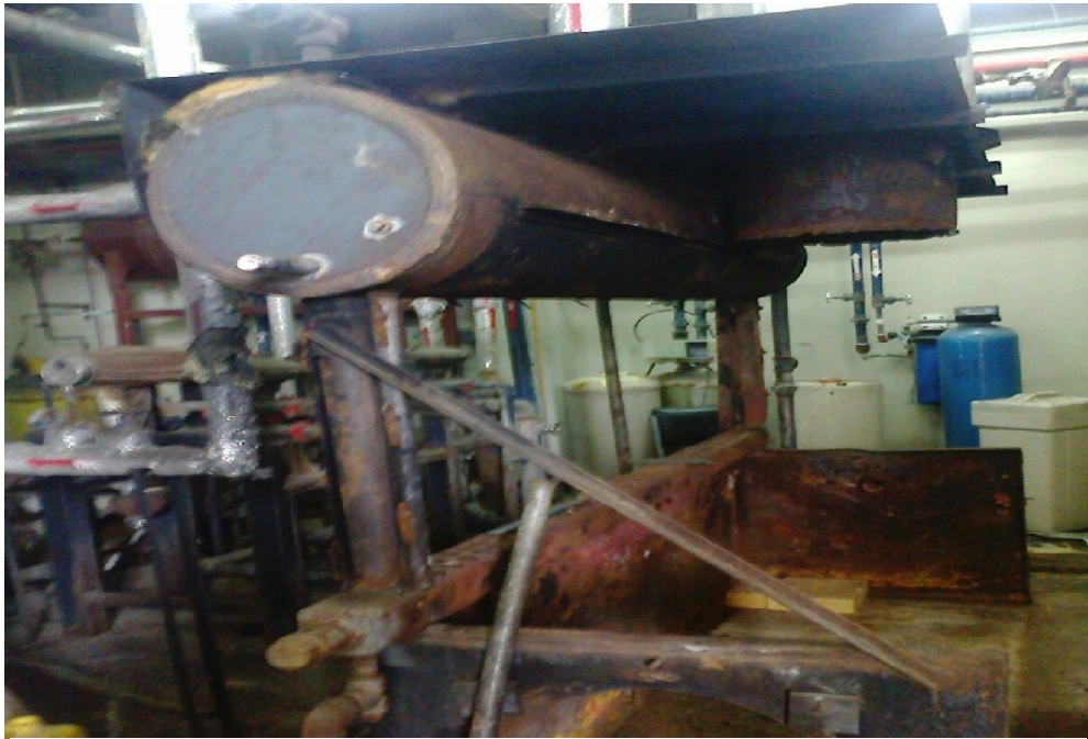
Estado en que se encontraba el sistema de vapor generado por los Calderos del Hospital General de Machala
