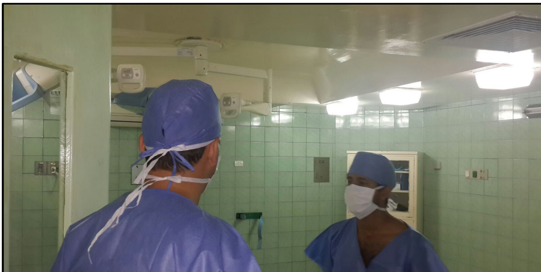
Área de Quirófano lista, puesta en funcionamiento de Lámpara Cielítica y correcto movimiento conforme lo requiera los especialistas en las cirugías.
